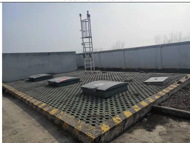
加油站油罐区
